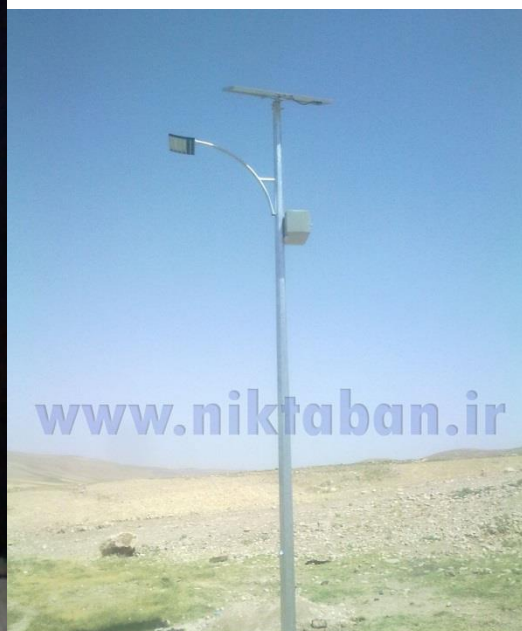
چراغ خیابانی خورشیدی مدل پرتو ۲ محل نصب : منطقه تفریحی اطراف شهر کميجان (استان مرکزی)
